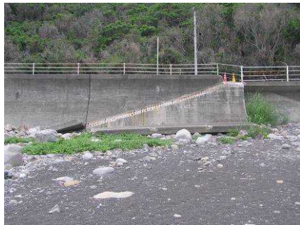
昇降坂は破壊されている。
